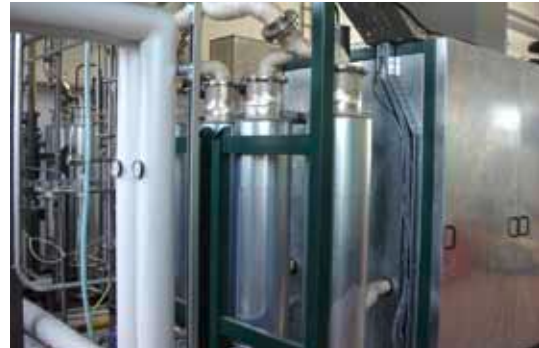
Biodiesel Erneuerbare Energien Blockheizkraftwerke (BHKW)
