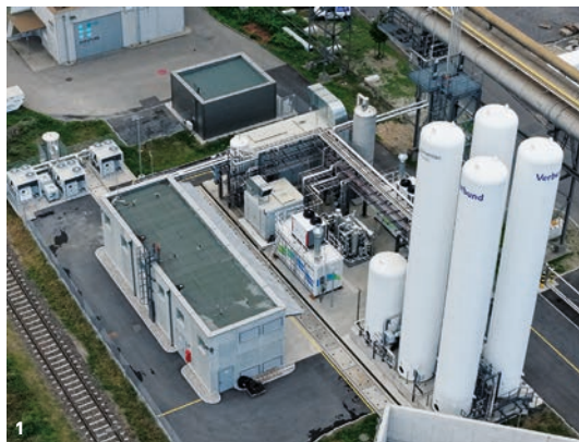
In der neuen Anlage wird Wasserstoff verdichtet, gereinigt und zwischengespeichert.
