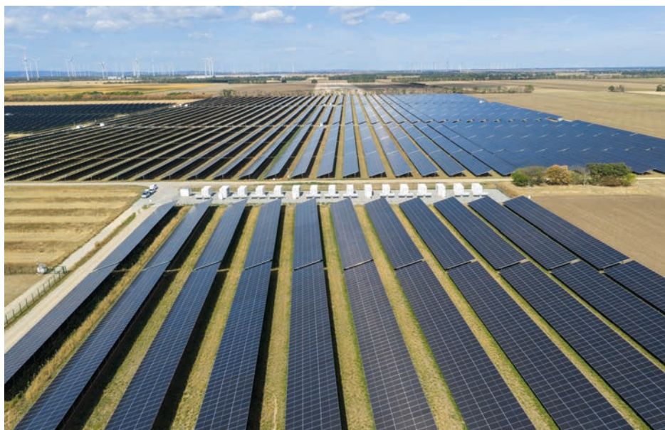
VERBUND vermarktet die Erzeugung des Super-Hybrid-Kraftwerks von PÜSPÖK in Nickelsdorf, das Photovoltaik, Windkraft und Batteriespeicher vereint.
