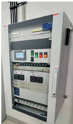
Bild li.: Gebäudefunkanlage in 19"-Technik
