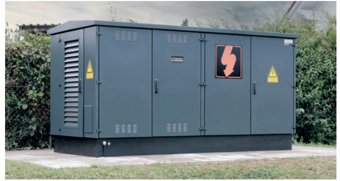
Die österreichweit erste smarte fabriksfertige, typgeprüfte Trafostation ist eine Siemens-Gesamtlösung und wurde kürzlich vom Elektrizitätswerk Fernetz in Betrieb genommen.
