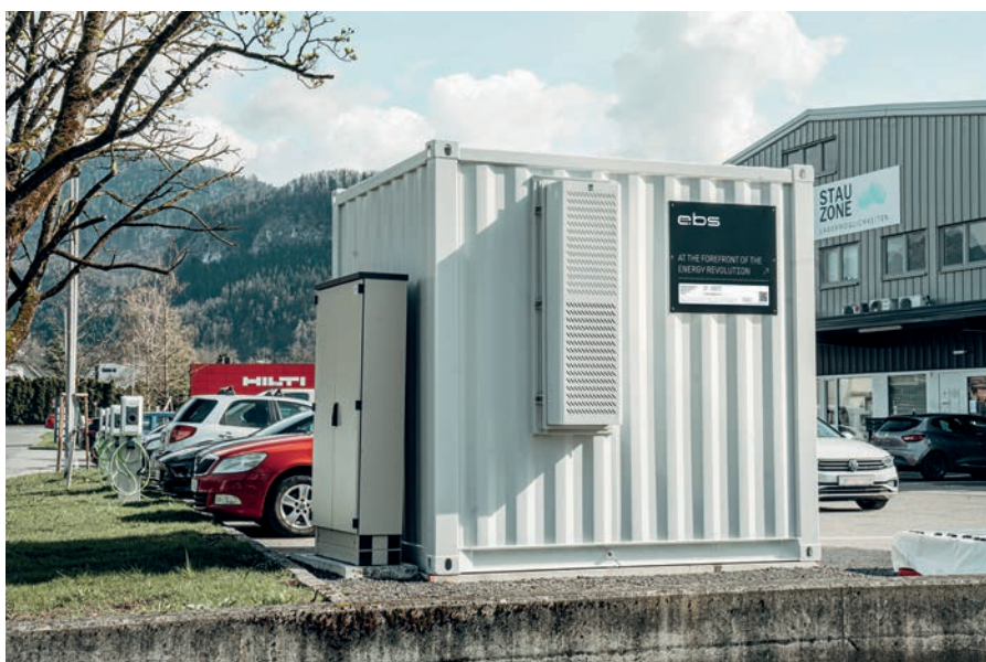
Ein 10-Fuß-Container mit 261 kWh Speicherkapazität ist das zentrale Element eines Projekts zur Eigenverbrauchsoptimierung und Netzstabilisierung.
