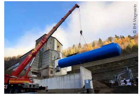
Im Werk Radenthein wird der LPG (Flüssiggas)-Tank in Betrieb genommen.
