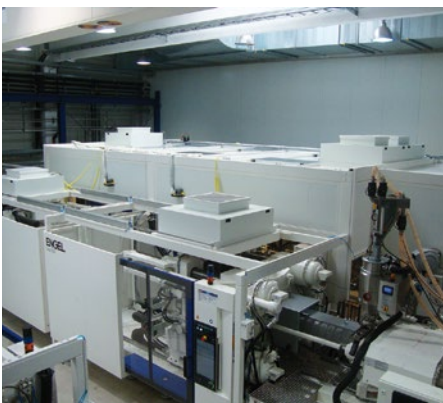
Reinräume für Kunststoffspritzgussanlagen
