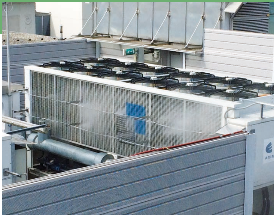
Wassersprühnebel steigert die Effizienz der zentralen Kühlanlagen beim LKH in Graz.
